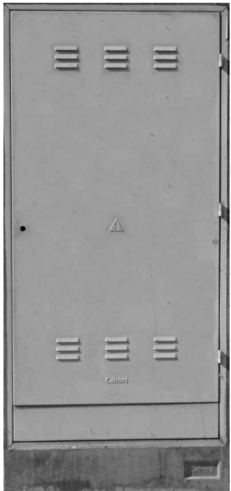
ARMARI ESCOMESA ELECTRICA PREFABRICAT
