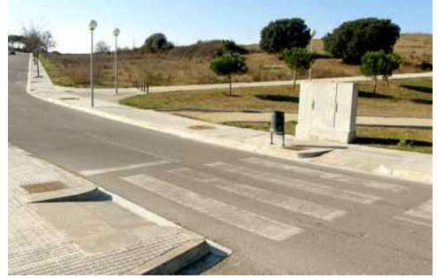
ARMARI DE COMANDAMENT ENLLUMENAT PÚBLIC
