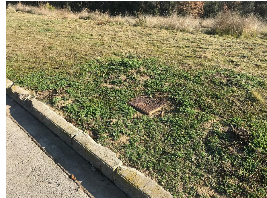
C/ CAROLINES - DETALL ESTAT VORADA-RIGOLA EXISTENTS
