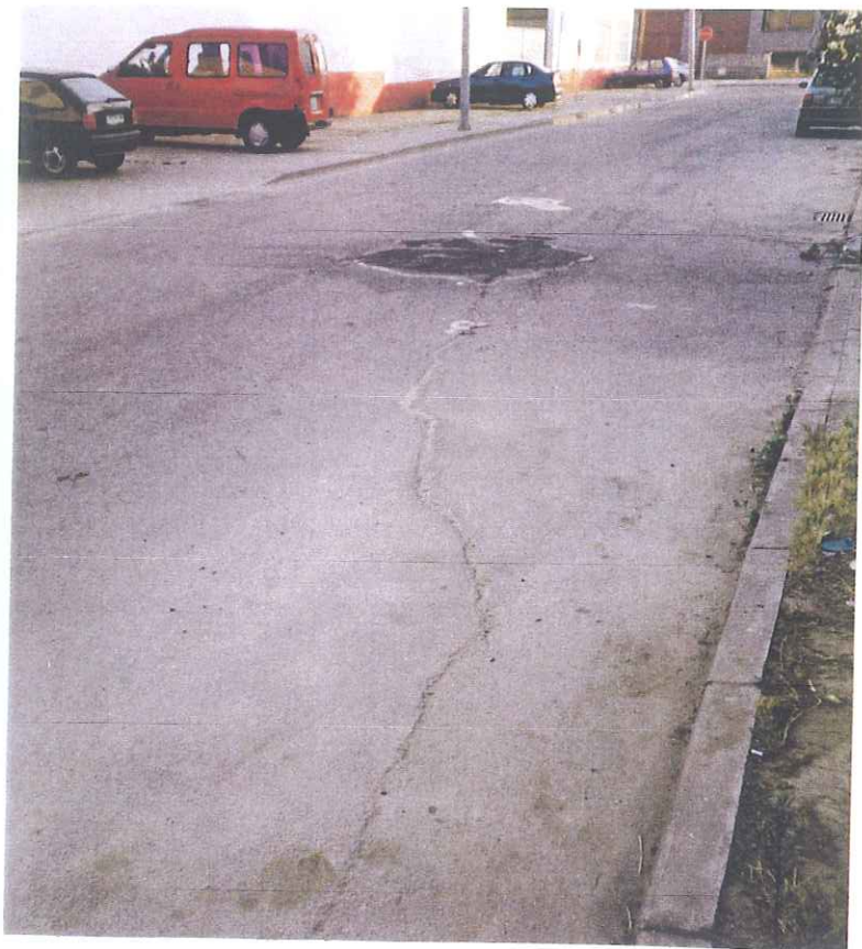
Foto 3: Visió de l'esquerda en l'asfalt del Carrer de l'Orfebreria. Al fons, nau de la fàbrica "La Menorquina"
