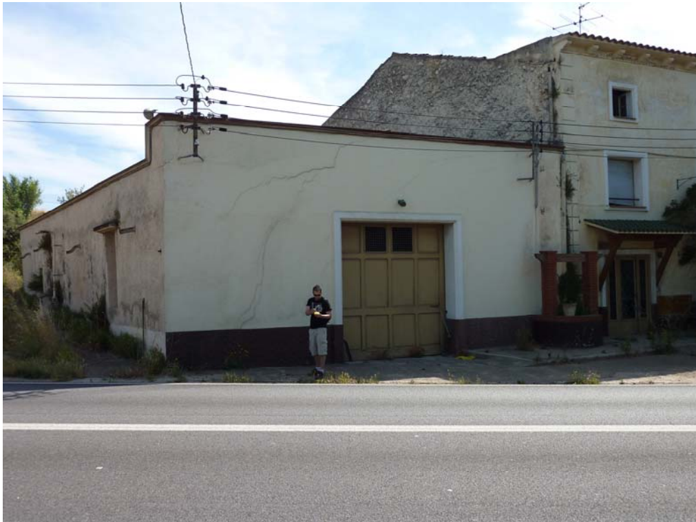
Fotografia 4: Edificació annexa a la masia de Can Periquet amb esquerdes, situada sobre la traça de la possible falla.
