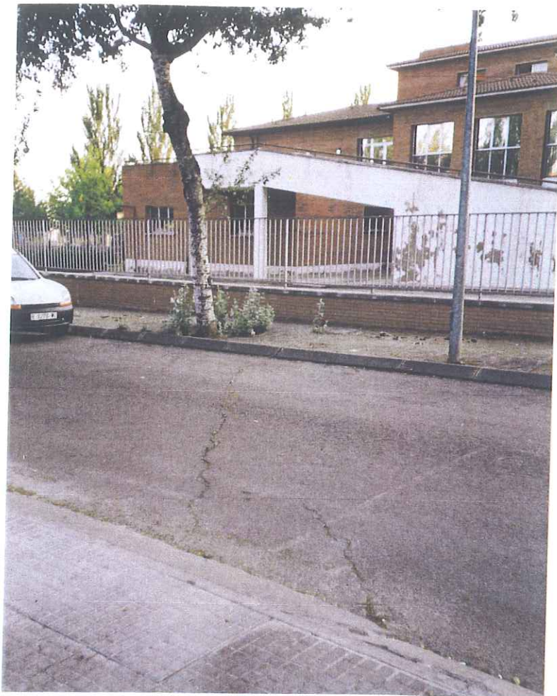
Foto 13: Vista de la fractura en l'asfalt del Carrer Sant Joan. Al fons, l'escola "El Sol".
