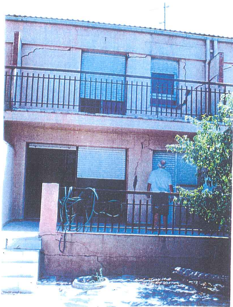
Foto 9: Visió de la façana posterior del n° 15 del Carrer Sant Isidre (de Francès, 1996), que mostra la magnitud dels desperfectes ocasionats
