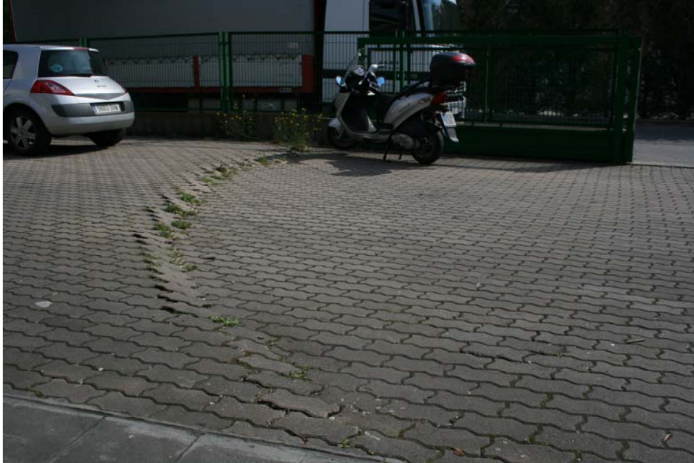
Fotografia 5: Esfondrament del paviment de l'entrada de la fàbrica Productes el de Caldes, al Polígon Industrial Riera de Caldes.
