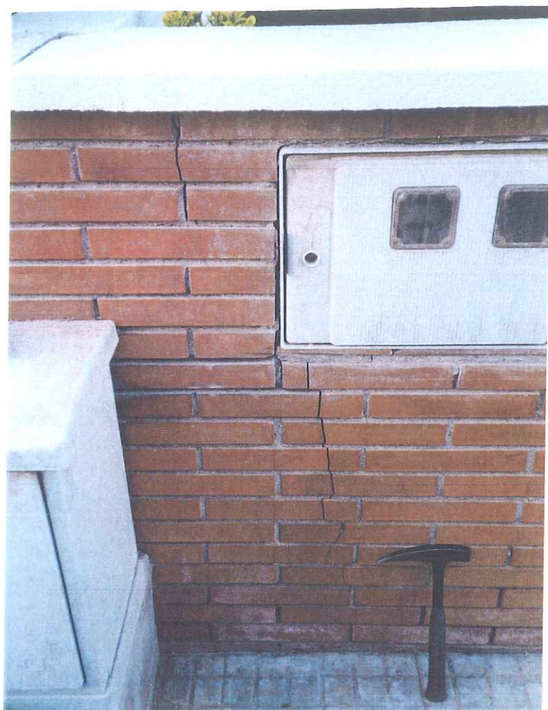
Foto 15: Esquerda en el mur del nº 27 del Carrer Migdia. Tant aquesta vivenda com la del nº 29 han precisat de ser reparades.
