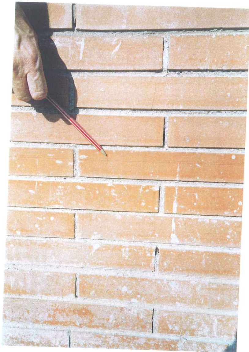
Foto 23: Detall del mur del nº 2 del Carrer Albes, en la cantonada amb el Carrer dels Til·lers. En aquest punt les esquerdes són ja de caràcter capil·lar.
