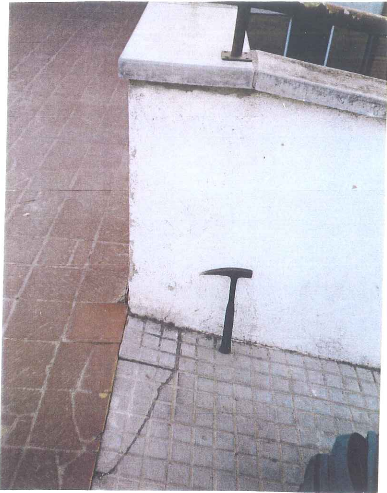
Foto 11: Estat actual de la rampa de l'escola "El Sol", que va precisar de ser reparada.
